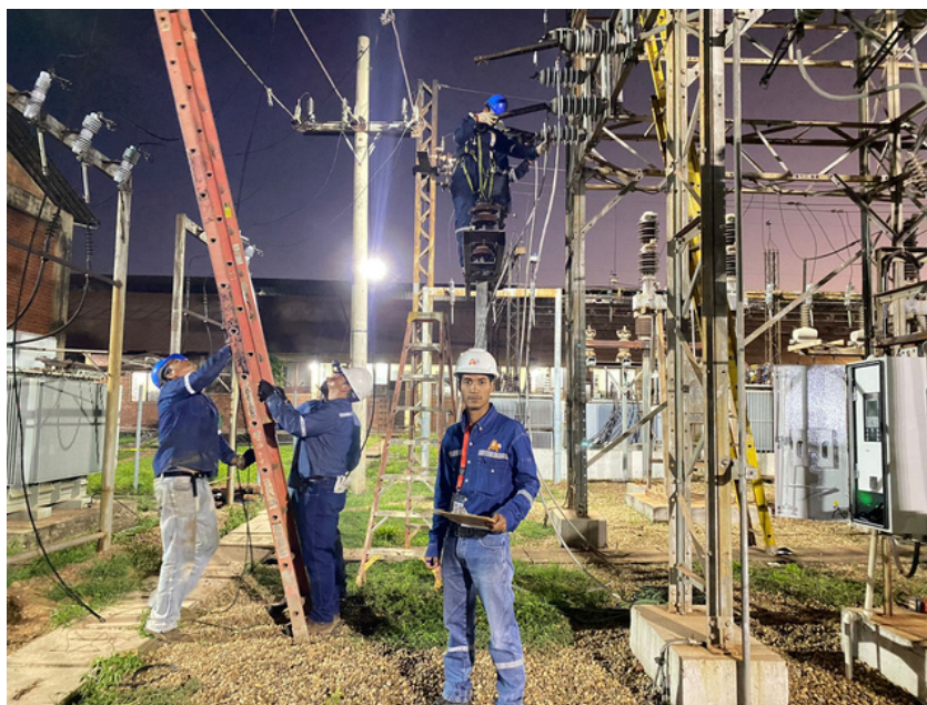
fiscalización a trabajos de ampliación de la barra principal en la Subestación de la Planta Termoeléctrica "El Palmar", Riberalta.
